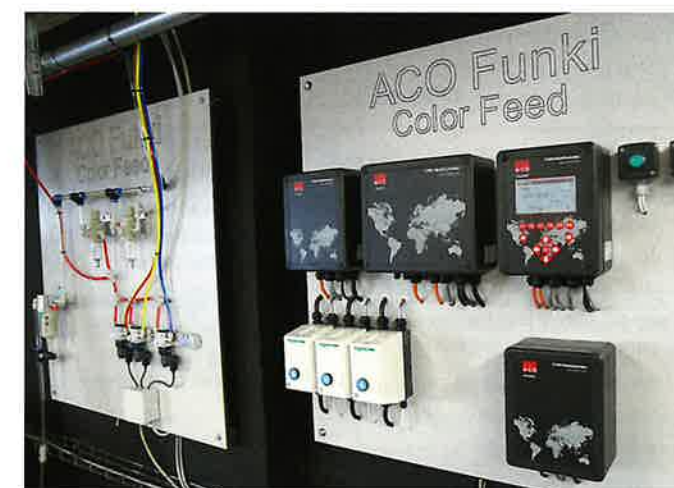
Funki Multicontroller kobles på ColorFeed-tørfoderanlægget og styrer fodringen.
