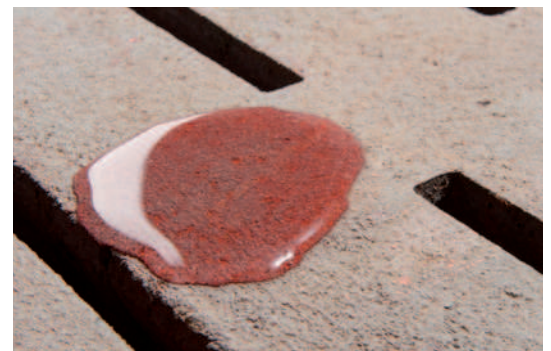
Säurefraß durch Futtersäure wird durch silikatische Versiegelung nachhaltig verhindert
